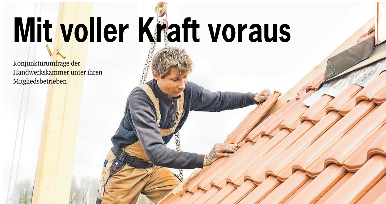
Das letzte Jahrige Hagelunwetter in den Landkreisen Reutlingen und Tübingen bescherte Zimmerern und Dachdeckern volle Auftragsbücher.
