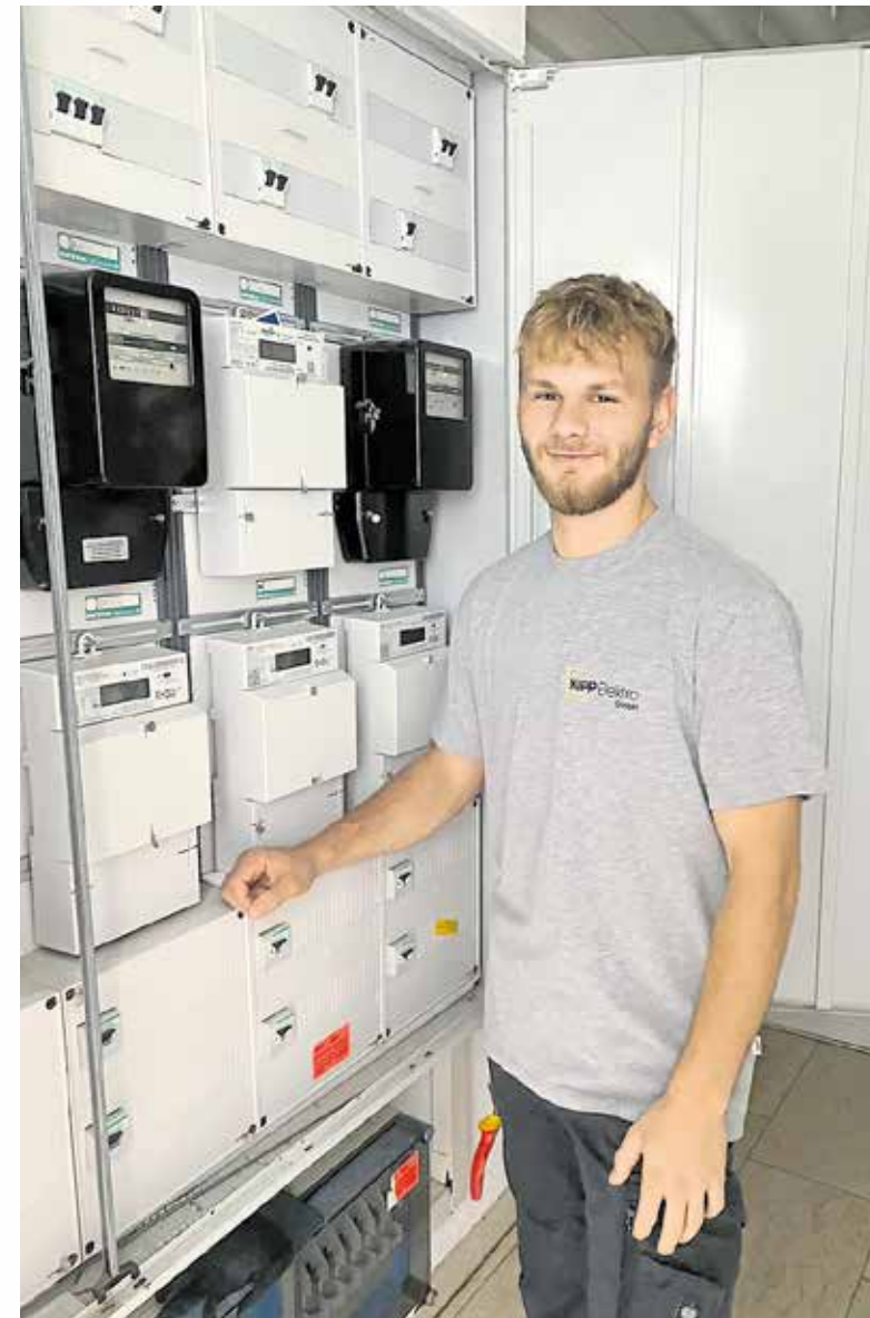
Schlitzlötlampe ist nicht so sein Ding, verrät Tim Salzmann. Umso mehr schätzt der Auszubildende die Arbeit am Verteilerkasten.
