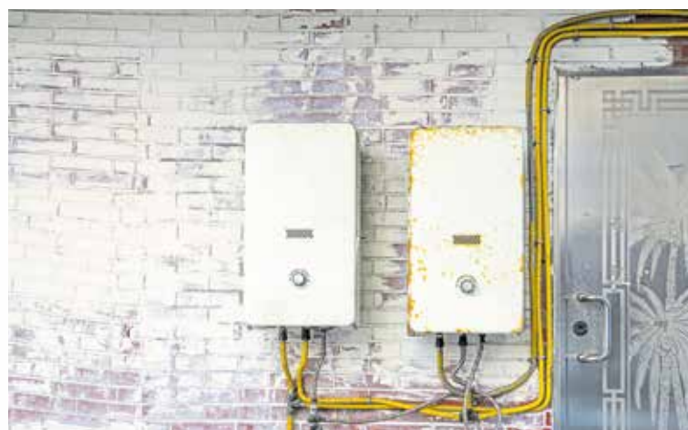
Wer sich einen neuen Wasserboiler anschafft, muss den alten nach dem ElektroG fachgerecht entsorgen lassen. Foto: Phatara Tithitwimol/Adobe Stock
