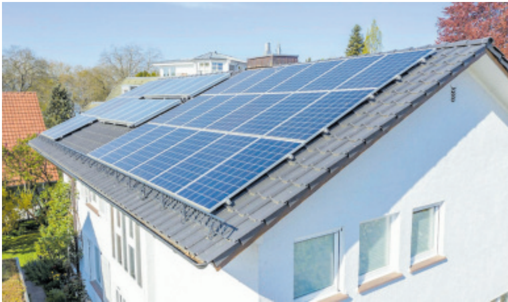
Photovoltaikanlagen lohnen sich weiterhin finanziell – zudem leisten sie einen wichtigen Beitrag zum Klimaschutz und erhöhen die Unabhängigkeit von steigenden Strompreisen. Bild: Plattform EE BW / Kuhnle & Knödler
