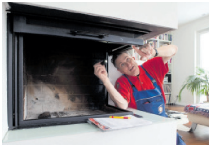
Reparatur, Wartung oder Austausch von Heizungsanlagen, Elektro-, Gas- und Wasserinstallationen zählen zu den Handwerkerleistungen, die steuerlich geltend gemacht werden können.
